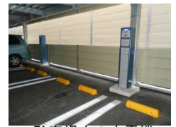
駐車場内の充電機
