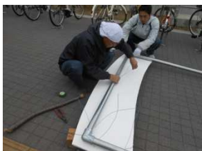
鉄パイプと看板を鉄線で結ぶ
